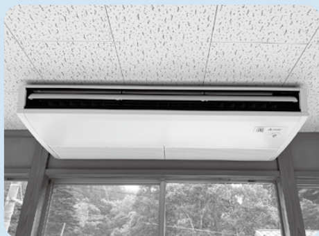
新たに設置されたエアコンには宝くじ社会貢献 広報事業のシールが貼られています
