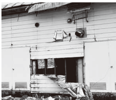
手付かずの空き家は危険です
