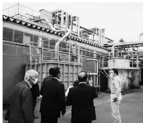
生ごみバイオガス発電センター
