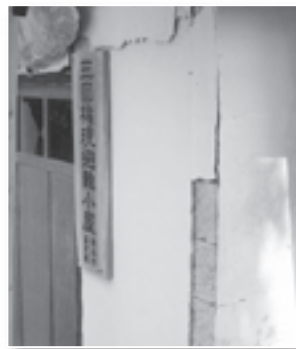
修復が急がれる三国権現避難小屋
