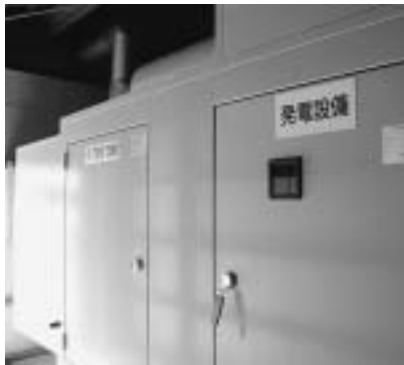
役場に新しく設置された非常用電源装置
