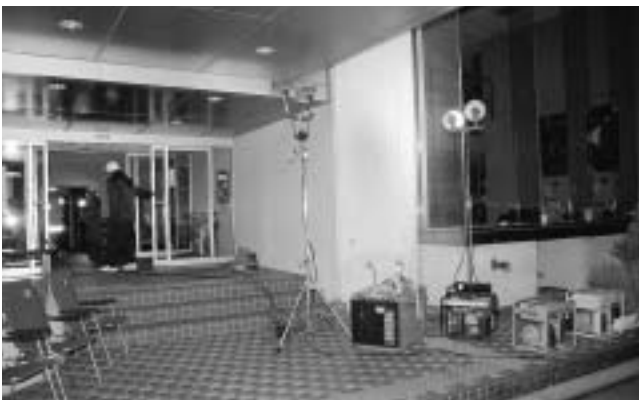
公民館に急ぎよ集められた各種電源装置
