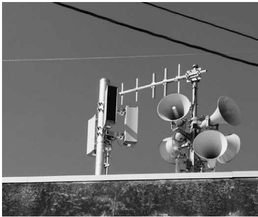
消防サイレン吹鳴スピーカー
