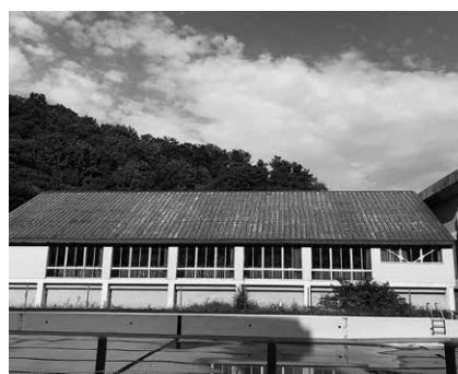
腐食が進んでいる屋根
