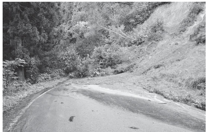
芝原三俣線、土砂崩れ現場
