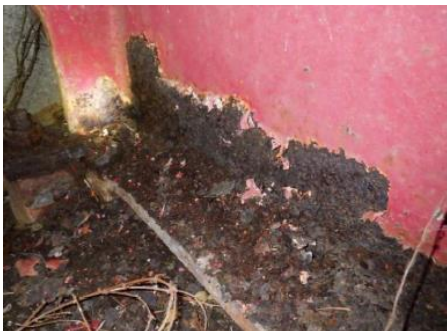
鋼桁の腐食等
