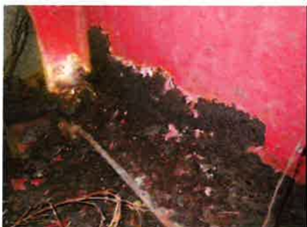
鋼桁の腐食等
