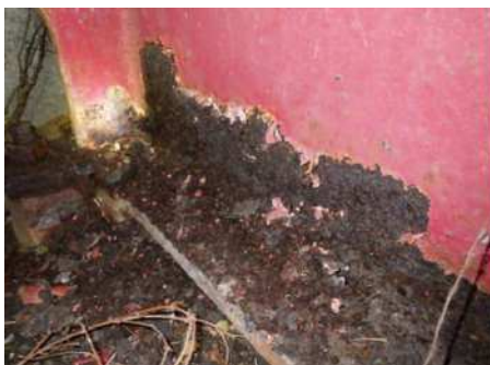
鋼桁の腐食等
