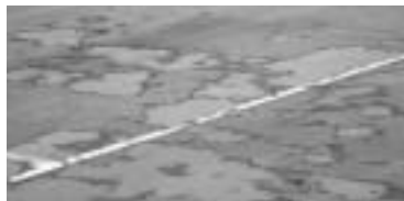
▲劣化テニスコート
